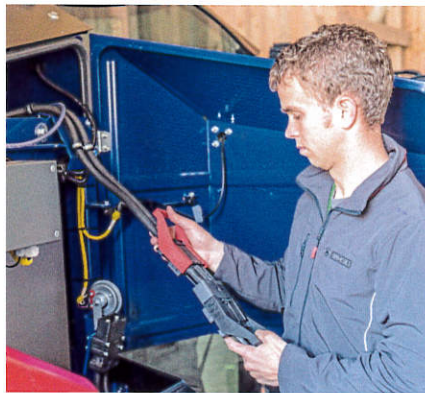
Das Ladegerät arbeitet mit einem 400-Volt-Anschluss. Über einen zweipoligen Stecker wird die Batterie geladen. Das dauert bei leerer Batterie ca. 11 Stunden.
